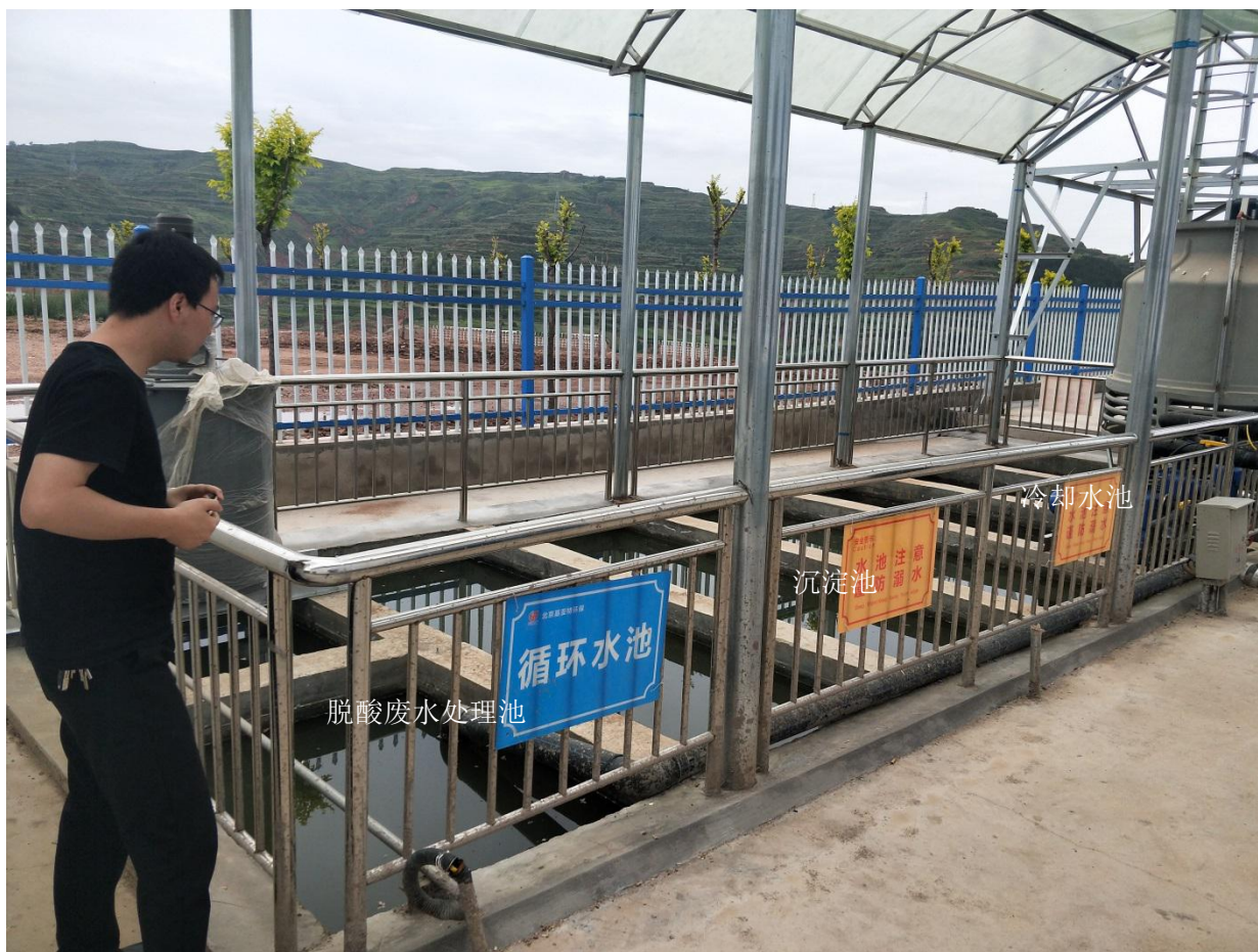
图 4-5 污水处理设施
