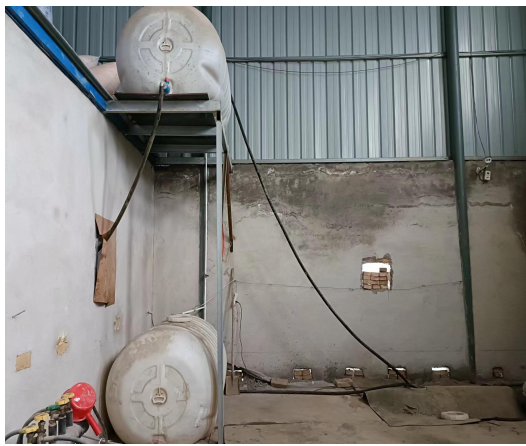
循环水罐及冷却水罐
