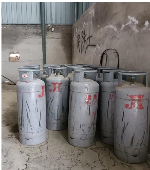
丁烷气储存区
